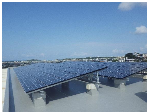
座安小学校太陽光発電設備
