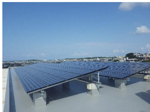
座安小学校太陽光発電設備
