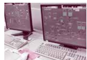
中央監視システム
