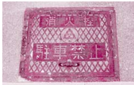
消火栓には駐車しないで下さい
