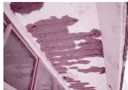
庇の剥離状況
