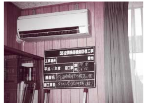
空調機器の設置状況
