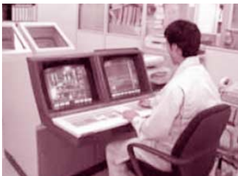
中央監視システム
