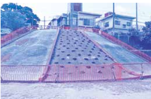
使用禁止になっているコンクリート製すべりスロープ
