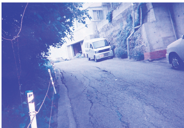
市道313号12月以前より窪みが広がる。下り坂で片側は崖つびちで危険
