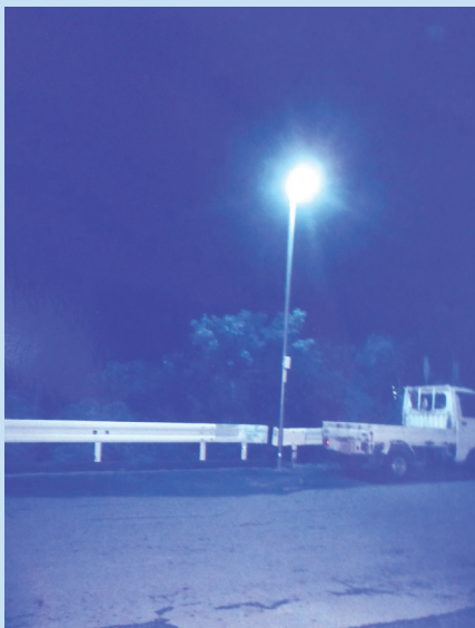
各自治会の防犯灯（水銀灯・蛍光灯）はLED照明に
