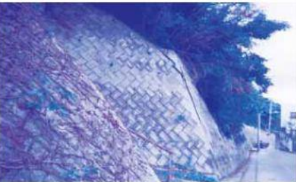
危険すぎる擁壁、豊見城ニュータウン地内
