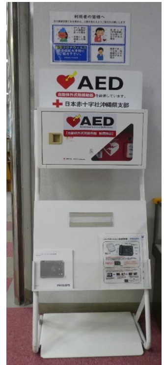
2F トイレ近くに設置されたAED
