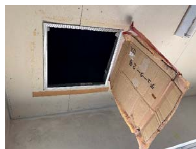
23 点検口蓋の破損
