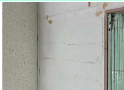
14 内壁のクラック
