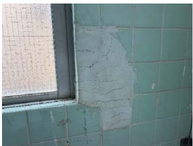
4 タイルの劣化
