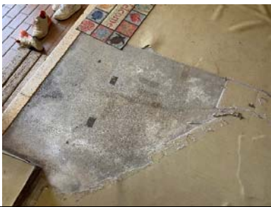
16 床材の劣化・破損
