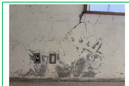
79 内壁のクラック
