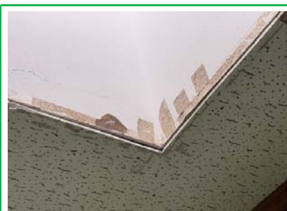
81 天井材の劣化・破損
