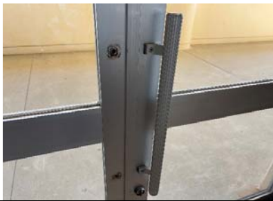
32 取っ手の破損
