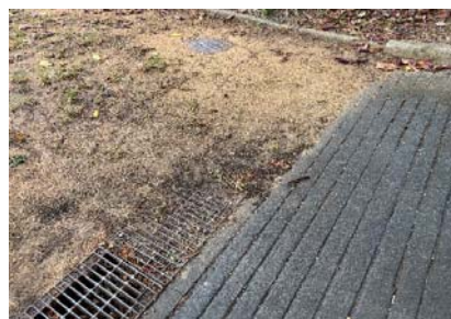
18 側溝への土の堆積
