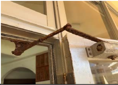
28 ドアクローザーの錆
