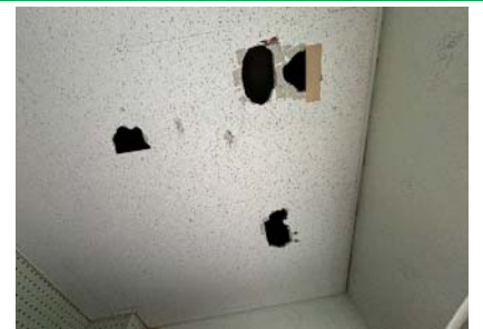
15 天井材の破損
