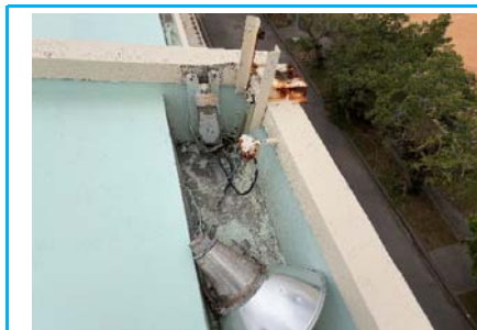
7 電気設備の破損
