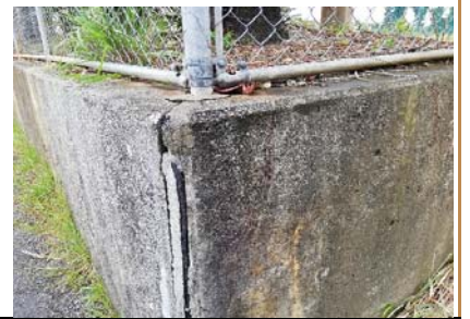
15 擁壁のクラック
