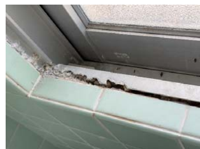
11 -2アルミ窓枠の劣化
