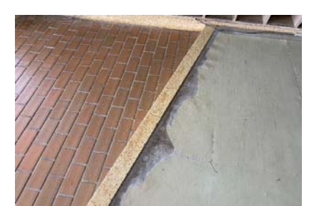
21 床材の劣化・破損
