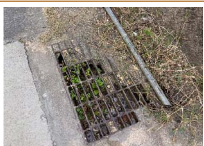
25 側溝への土の堆積
