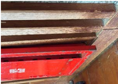
13 消火器扉の破損
