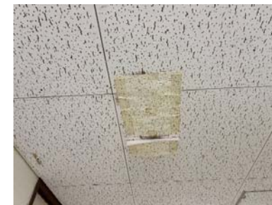
5 天井材の劣化・破損
