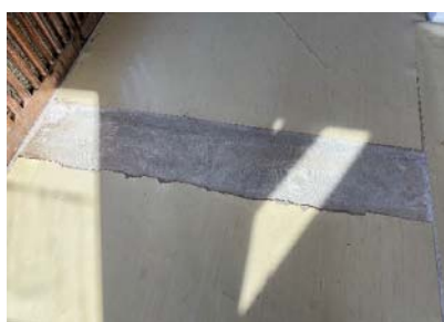
38 床材の劣化・破損
