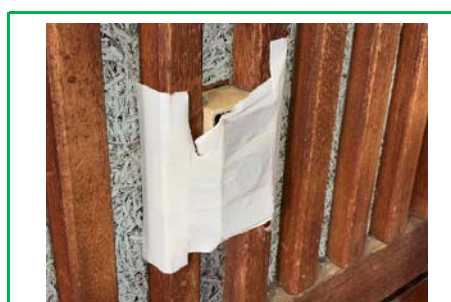
7 コンセントの破損
