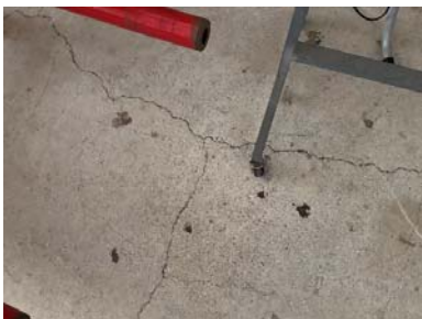
19 床コンクリートのクラック
