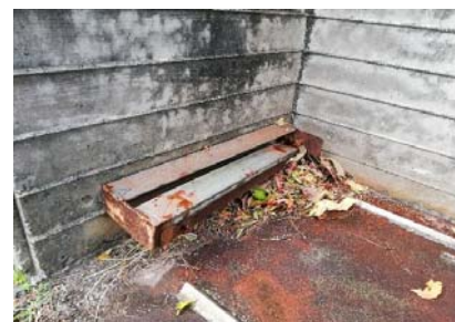
20 門扉ストッパーの破損
