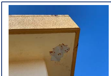
14 スラブ塗装の劣化
