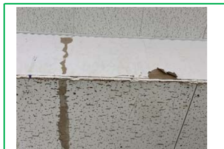
17 天井材の劣化
