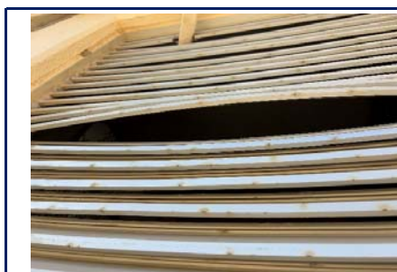
11 ガラリの破損
