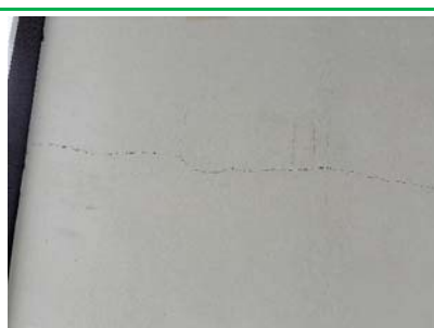
74 内壁のクラック
