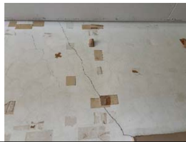
17 内壁のクラック
