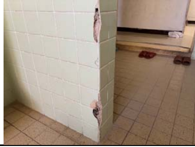
26 タイルの破損
