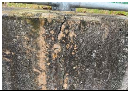
11 擁壁のクラック
