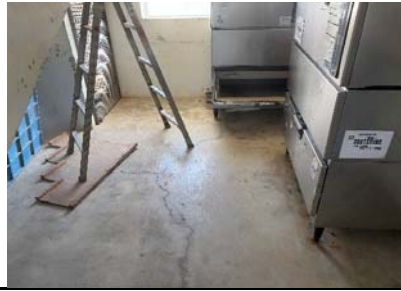
29 床コンクリートのクラック
