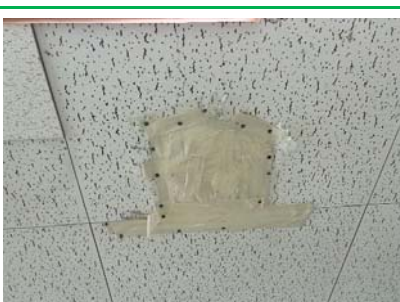
80 天井材の破損
