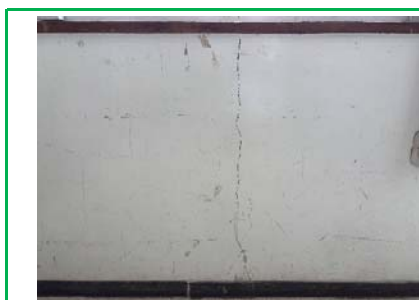
15 内壁のクラック
