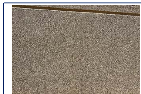
12 外壁のクラック
