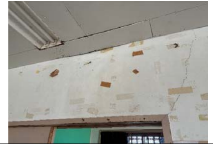
18 内壁のクラック及び天井材の破損
