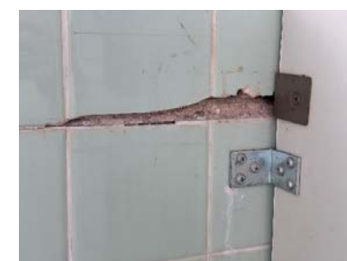
11 -1タイルの破損
