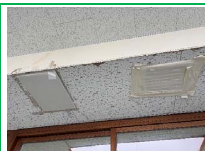
75 天井材の破損
