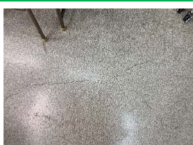
8 床材のクラック
