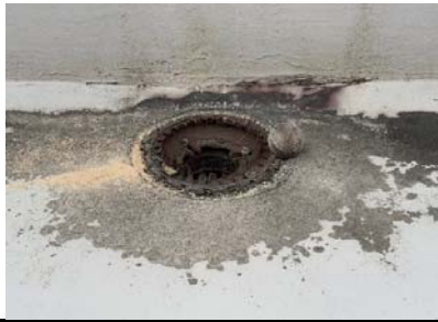
1 ドレンの破損(多数)
