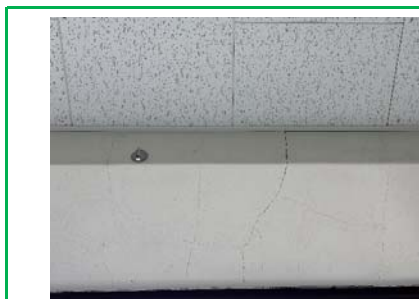
18 梁のクラック
