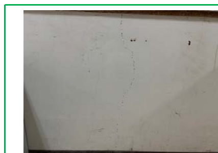
25 内壁のクラック
