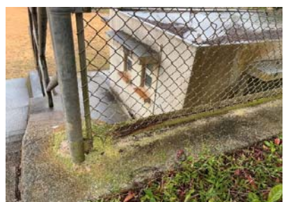
21 フェンスの劣化・破損
