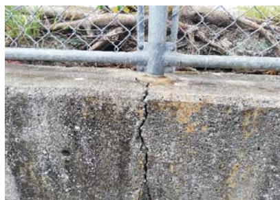
16 擁壁のクラック
