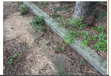
9 側溝の詰まり
