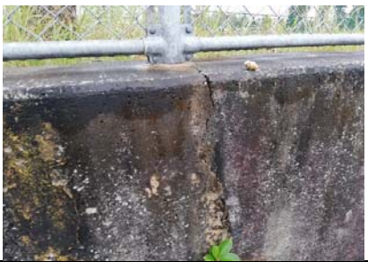
13 擁壁のクラック
