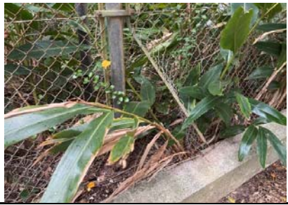
5 フェンスの破損
