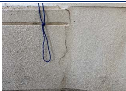
8 外壁のクラック
