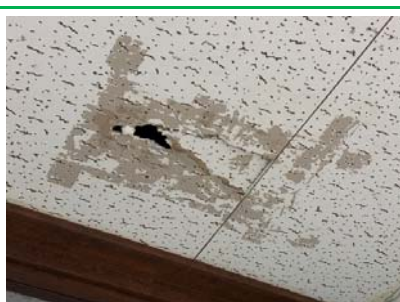
77 天井材の破損
