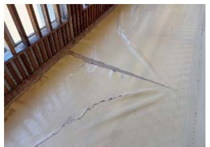
39 床材の劣化・破損
