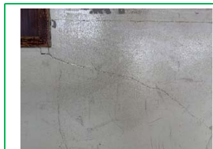
19 内壁のクラック
