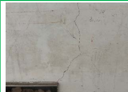
72 内壁のクラック
