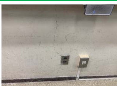
7 内壁のクラック
