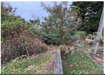
7 フェンスの破損・倒れ
