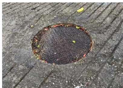
19 マンホールの陥没
