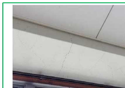
16 梁のクラック
