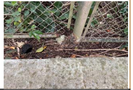
6 フェンスの破損
