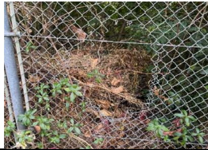
2 フェンスの破損
