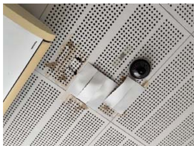
9 天井材の劣化・破損
