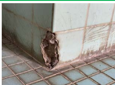
71 タイルの破損
