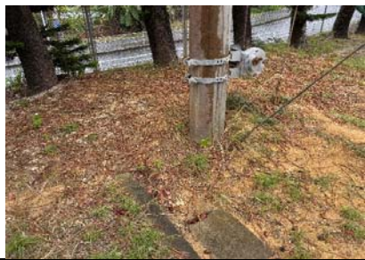
14 側溝への土の堆積
