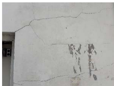
2 内壁のクラック
