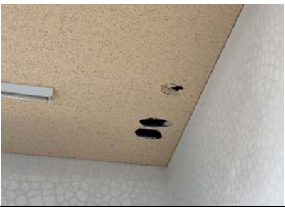
31 天井材の破損
