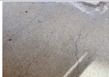
2 土間コンのクラック
