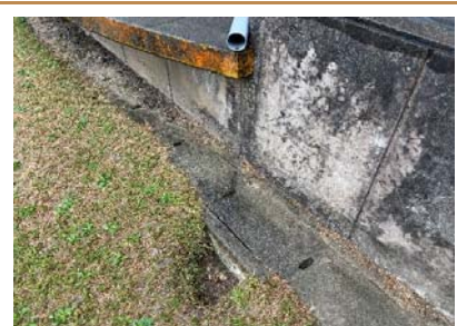
26 雨水排水による陥没
