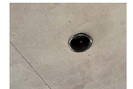
24 照明設備の破損
