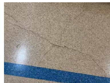
3 床材のクラック
