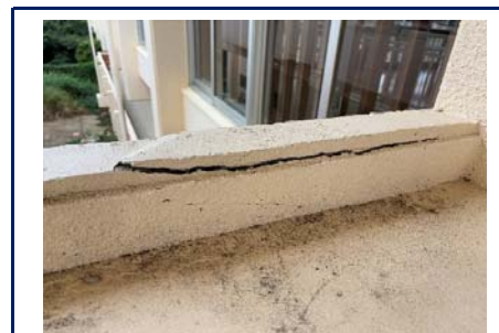
15 外壁のクラック
