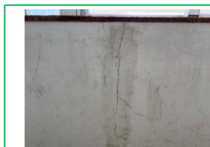
27 -1内壁のクラック
