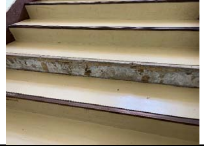
27 床材・ノンスリップの破損
