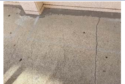
3 土間コンのクラック
