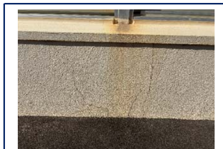
13 外壁のクラック
