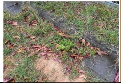
12 側溝の詰まり
