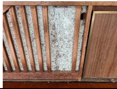
11 木リブの破損
