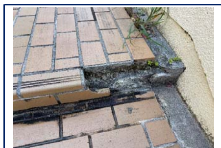
10 タイルの破損
