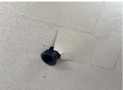
35 照明設備の破損
