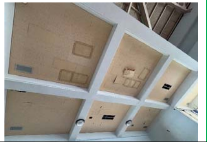
33 天井材の劣化・破損
