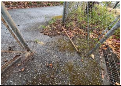
10 フェンス扉の劣化・破損
