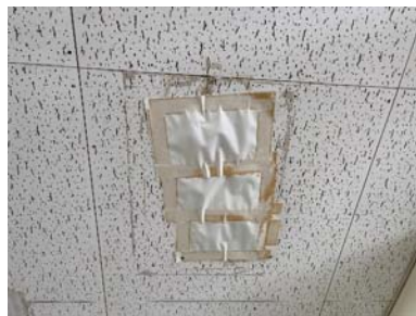
5 天井材の劣化・破損
