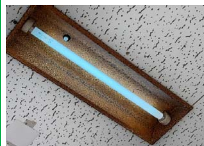
69 照明設備の錆(多数)
