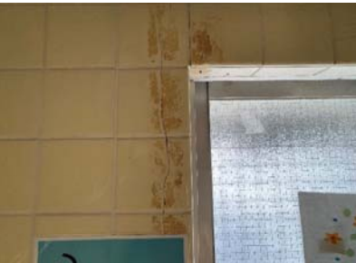
12 タイルの破損(縦ひび)
