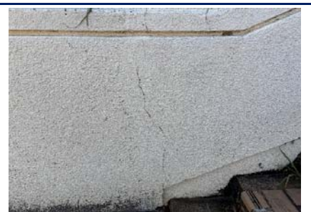
9 外壁のクラック
