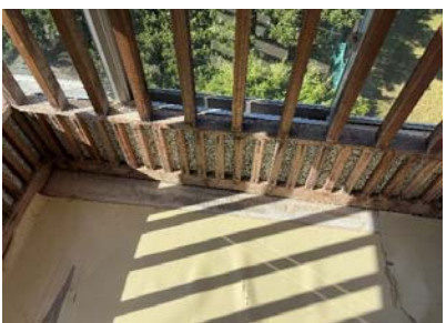
37 床材の劣化・破損(2階ギャラリー広範囲)
