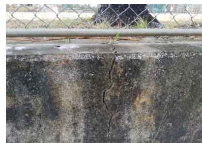
17 擁壁のクラック
