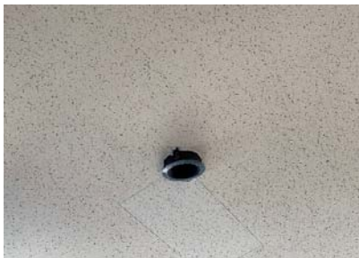
34 照明設備の破損
