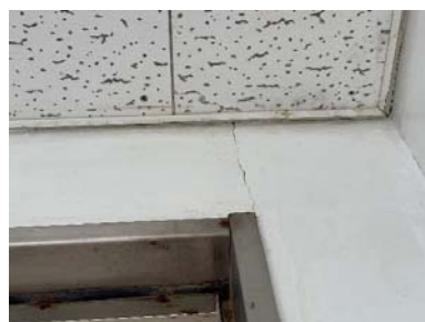
10 内壁のクラック
