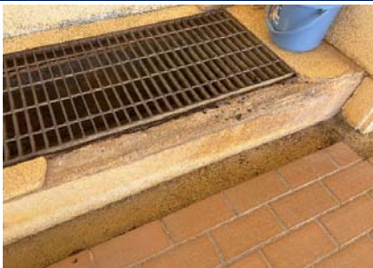
1 水飲み場のモルタルの破損
