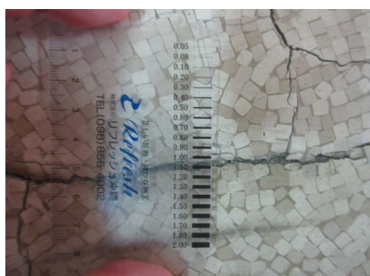
床（仕上げ）ひび割れ
