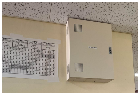
廊下に露出設置された後付けHUB BOX
