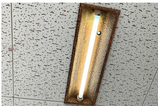
既存の照明器具
