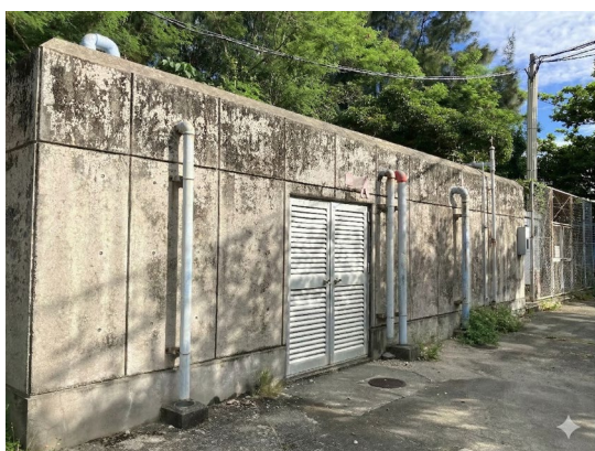
既存の受水槽、消火水槽、ポンプ室
