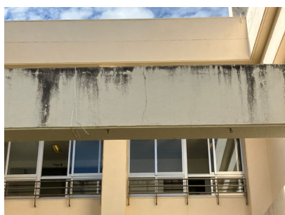
大梁ひび割れ
