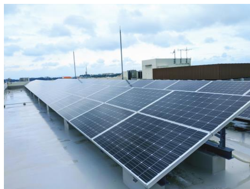
市役所屋上の太陽光発電設備
