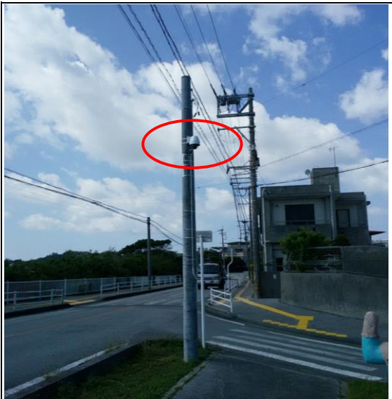
5 豊見城市字饒波499-6 新設柱
