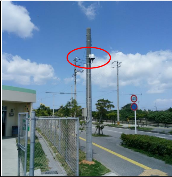
1 豊見城市字豊崎1-406 新設柱
