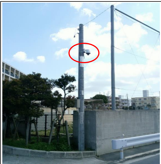
17 豊見城市字座安230-1 新設柱
