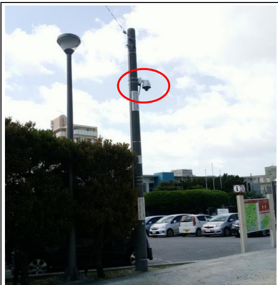
11 豊見城市字上田563 新設柱
